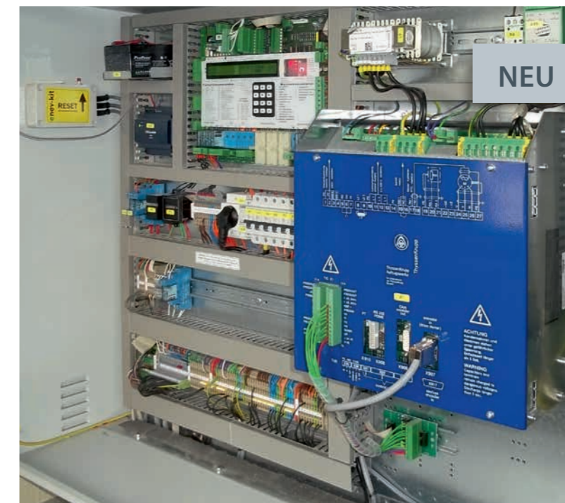
Zeitgemäße Steuerung mit Frequenzumrichter
